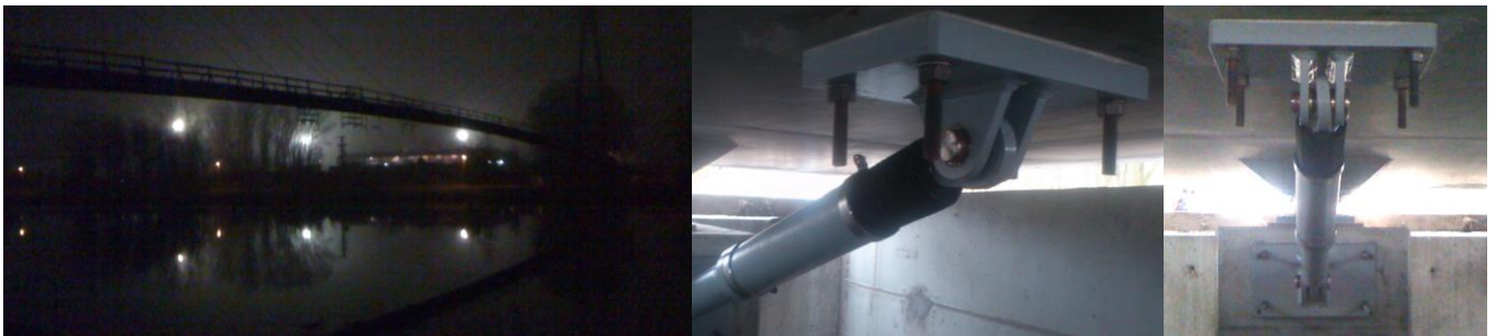
Hydraulický tlumič kmitů na cyklistické lávce přes Labe v Čelákovících
